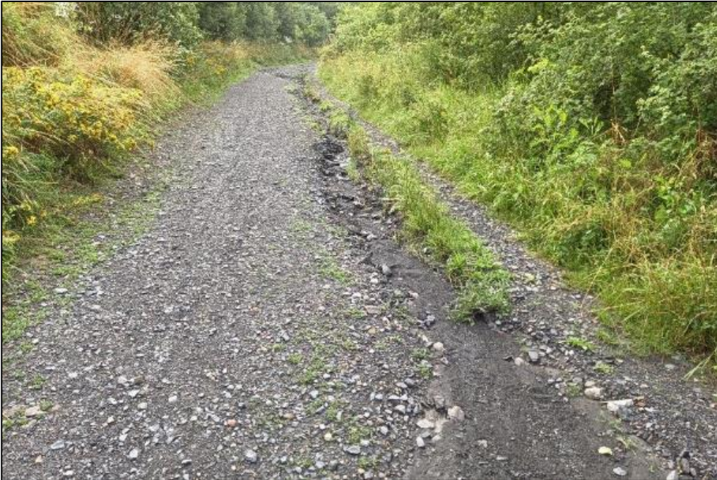
Abbildung 73 Bestandsaufnahme eines stark von Erosion, Tritt und teils auch Befahrung geprägten Wegabschnitts auf dem südlichen Schotterweg zum ersten Plateau (07/2021)
